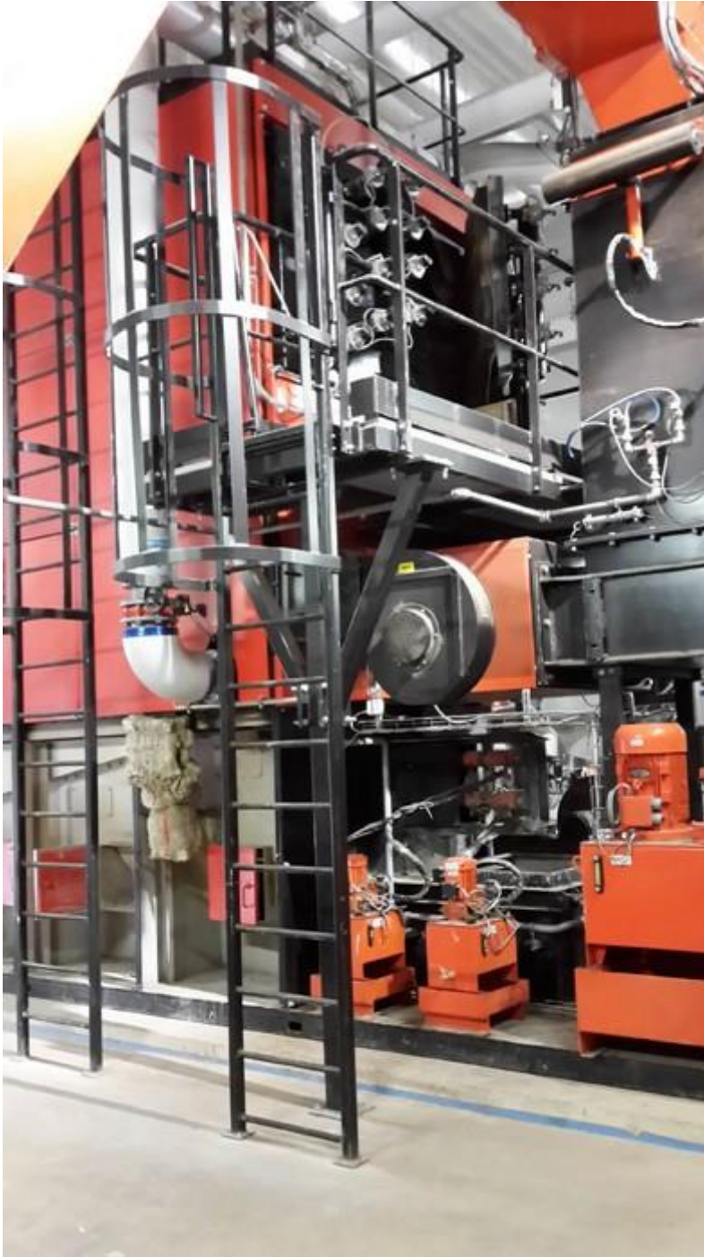
Chaudière biomasse (plaquettes bois) d'une puissance de 2,5 MW.
